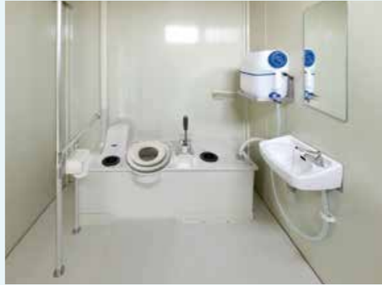
[室内/ポンプ式簡易水洗]
